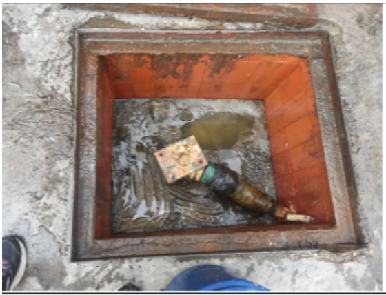
Foto No. 3. Boca del pozo deshabilitada, según oficio 2013EE176411 del 23/12/2013
