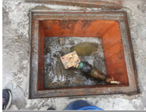
Fotografía 2. Boca del pozo según oficio 2013EE176411 del 23/12/2013, la cual no se pudo destapar la tapa de concreto para verificar condiciones físicas y ambientales el día de la visita realizada el 15/11/2017
